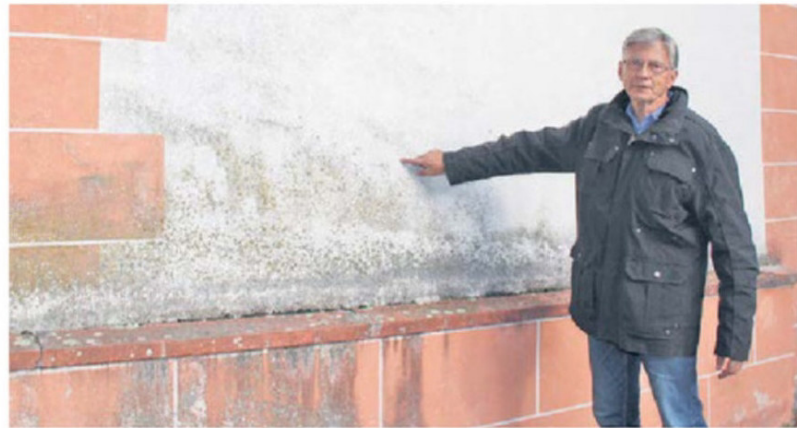
Dringender Sanierungsbedarf: Der Vorsitzende des Fördervereins St. Laurentius, Bernhard Kremser, zeigt die Feuchtigkeitsschäden an der Kirche. (Foto: BBW)
